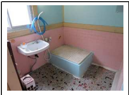
浴室・洗面台
